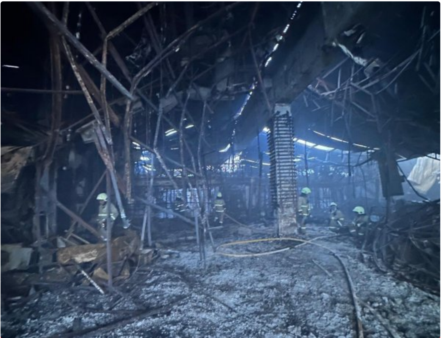
Glodok Plaza yang Hangus Terbakar
